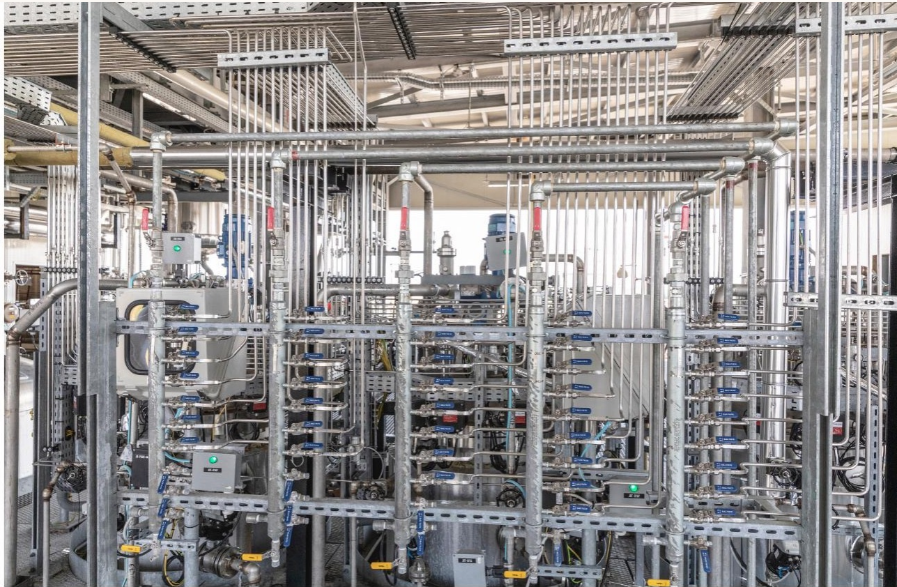
Dettaglio delle linee di processo e della strumentazione.
