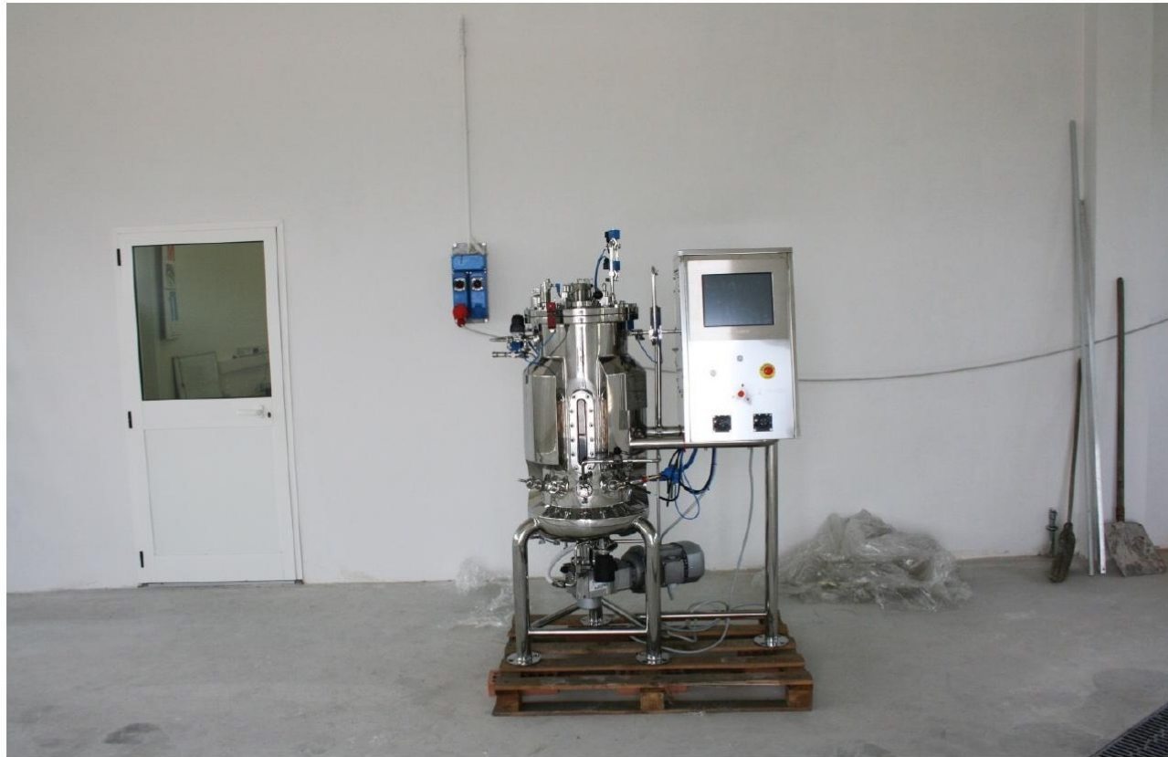
Reattore di processo e quadro di controllo.
